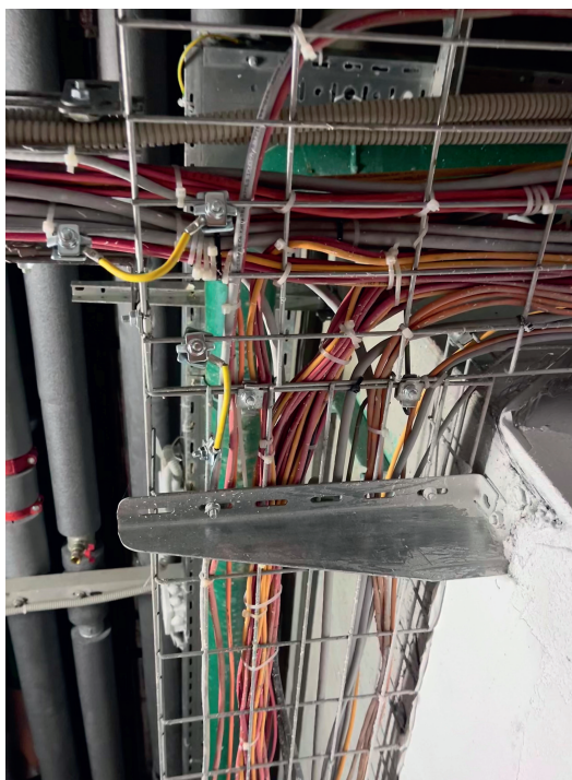
Пример применения кабельных стяжек и клемм заземления в ЖК
