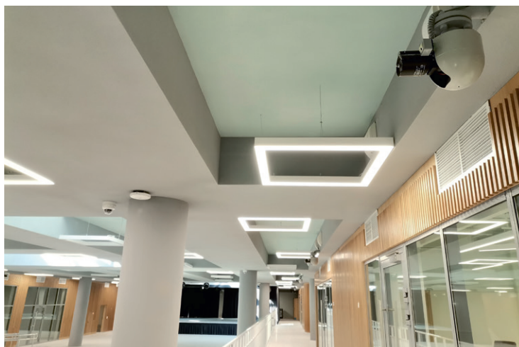
Рис. 1. РУП на базе пожарных мини-роботов для защиты помещений школы начального общего образования (Москва)
