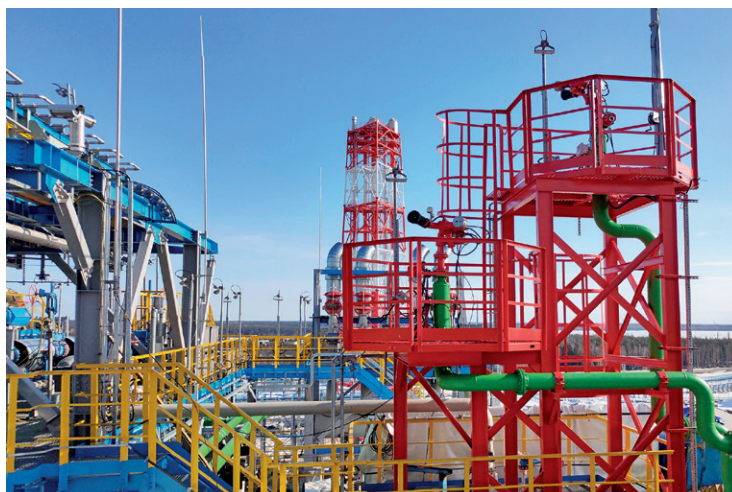
Рис. 2. РУП во взрывозащищенном исполнении для защиты комплекса по производству, хранению и отгрузке сжиженного природного газа (Ленинградская обл.)
