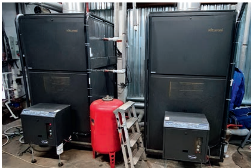
■ Рис. 4. Котельная на базе двух дизельных котлов Kiturami KSO-400 суммарной мощностью 930 кВт
