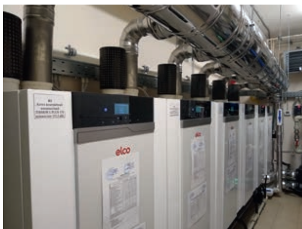
▪ Котельная БЦ «Оптима», Санкт-Петербург
