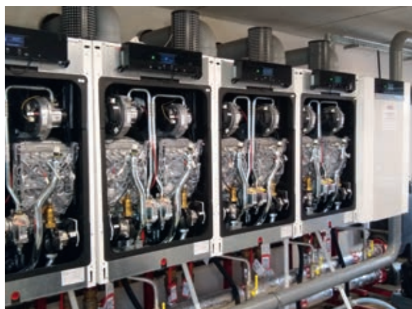
▪ Котельная ЖК «Горький», Калининград
